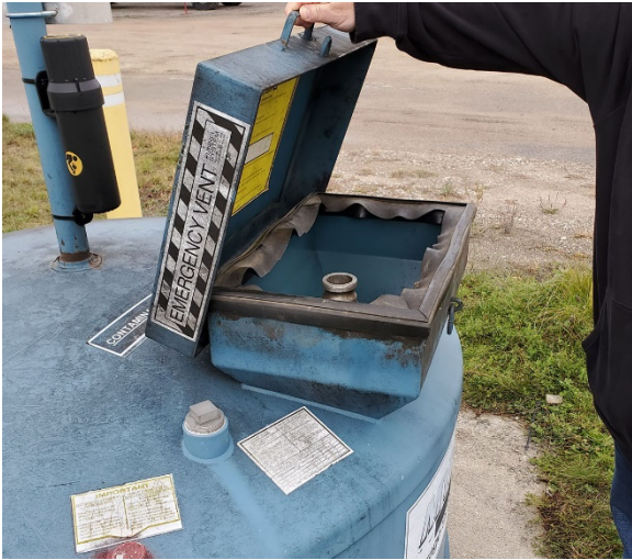
Spill box clear.
